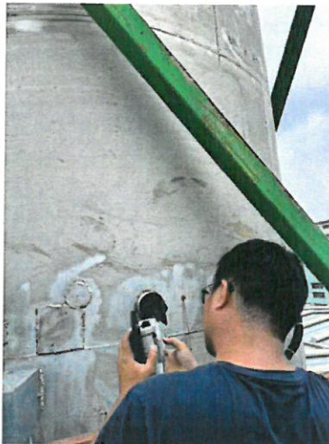
103A 硫化 72 课车间排气筒 出口 (FO-440203)
