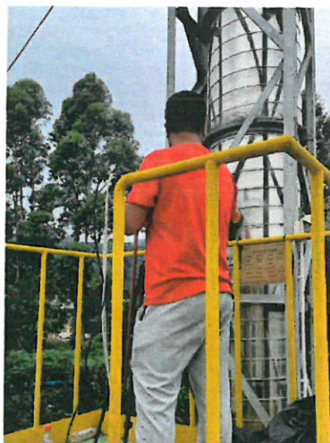
302 检修排气筒出口 (FQ-440213)
