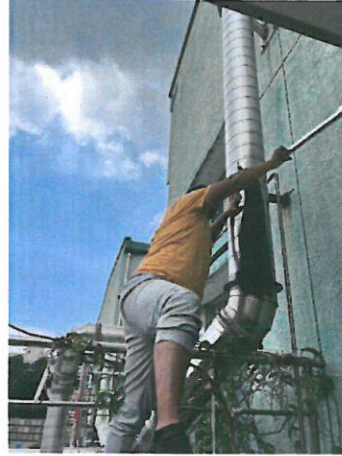
104 检修排气筒出口 (FO-440212)
