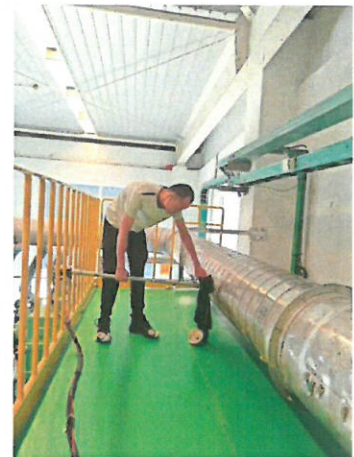
106 配料室排气筒 2#出口 (FO-440216)
