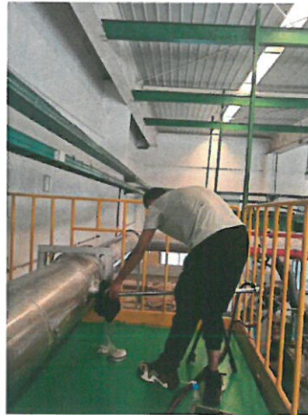
106 配料室排气筒 1#出口 (FO-440215)
