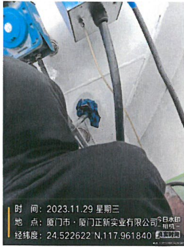
101 混炼车间废气排放口 (FO-440201)
