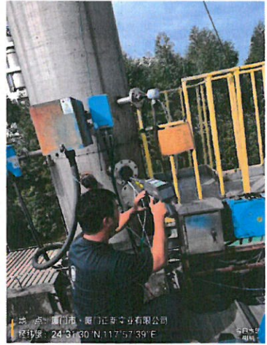
205 淋幕车间排气筒 出口 (FQ-440202)
