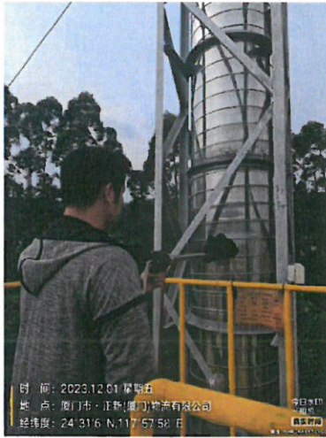
302 检修排气筒出口 (FQ-440213)
