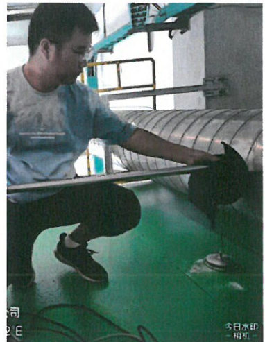
106 配料室排气筒 2#出口 (FO-440216)
