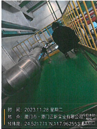
106 配料室排气筒 1#出口 (FO-440215)
