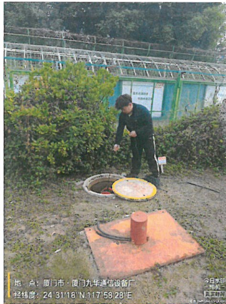
污水站出口 (DW001)
