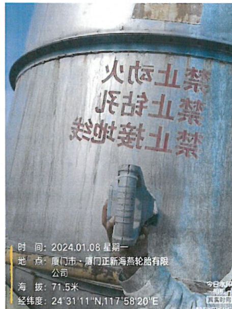
505 硫化车间排气筒出口 (DA016)
